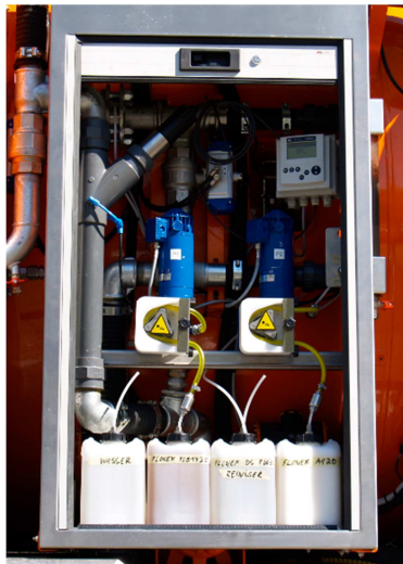
Beflockungseinheit Flocculation unit
